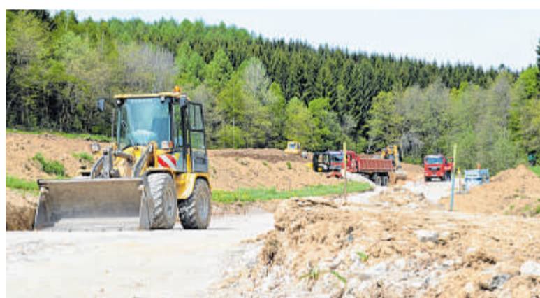
Die Bauarbeiten für die Autismus-Wohnanlage in Unglinghausen haben begonnen. Demnächst wird die Baustelle feierlich eröffnet.
